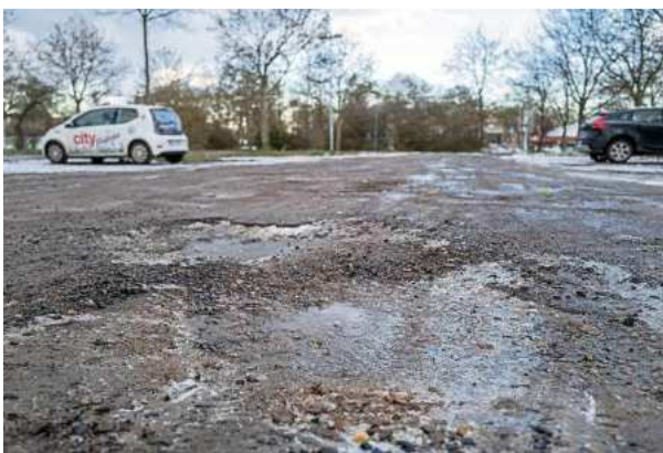
Der Parkplatz gegenüber vom Schwimmbad ist in einem bedauernden Zustand. Der Ortsbeirat möchte zumindest eine kurzfristige Verfüllung der größeren Löcher erreichen. Foto: Sämmer/hbz (Archiv+)
