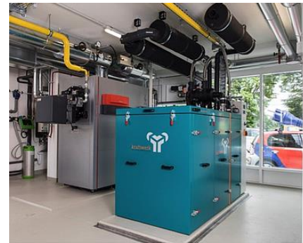
Abbildung: Erdgas-Brennwertkessel (links im Hintergrund)
