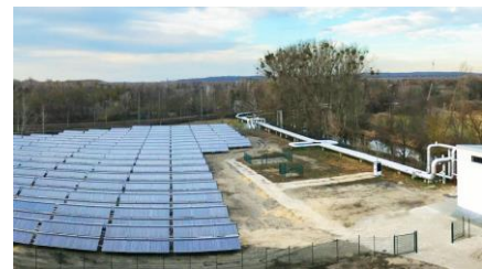
Abbildung: Kollektorfeld mit 5157 Quadratmetern Vakuumröhrenkollektoren von Ritter XL Solar (Stadtwerke Potsdam). (2)
